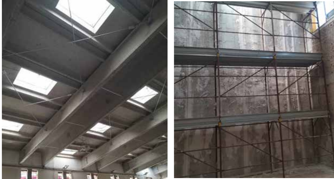
irrigidimento della copertura mediante controventatura con tiranti e sistema antiribaltamento ai tamponamenti
